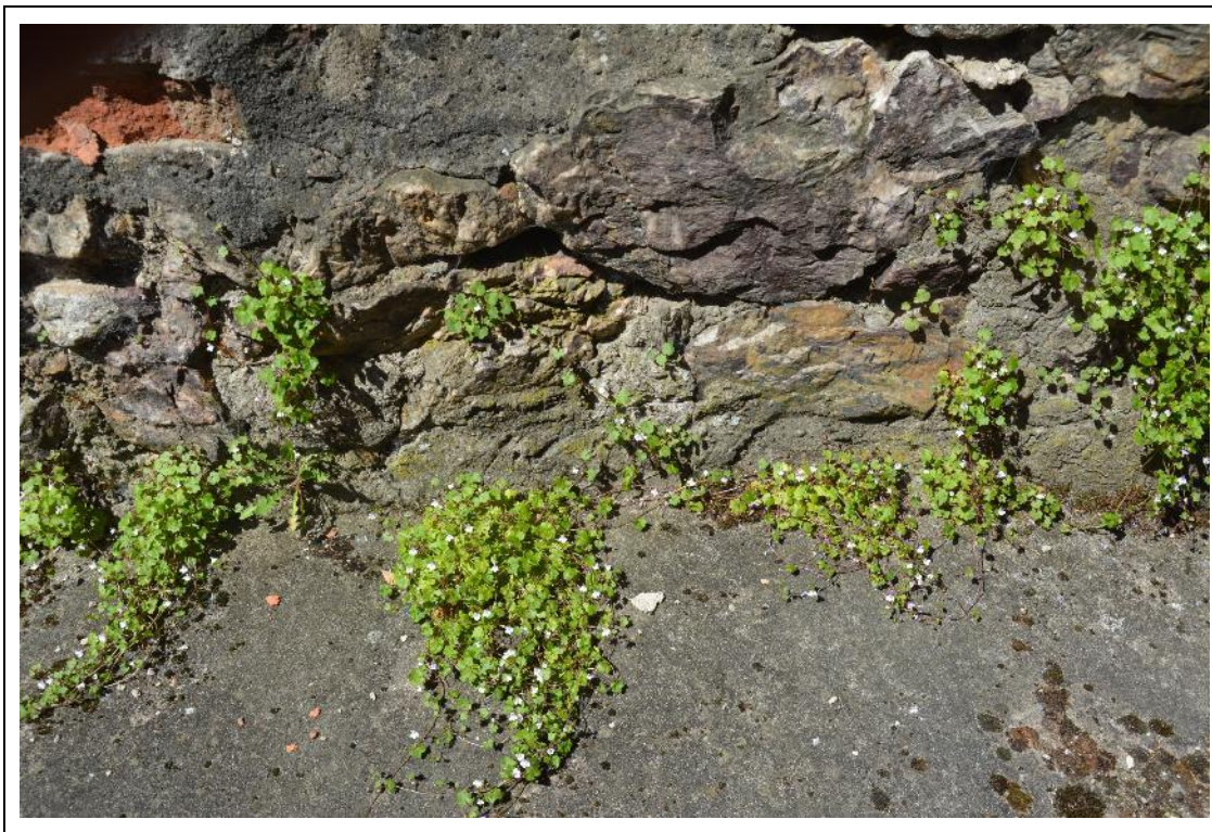
Abbildung 8: Mauerfugenvegetation am Kirchhof
