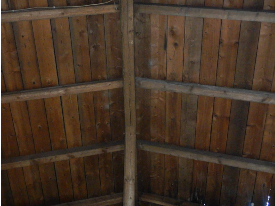
Abb. 54: Im Bereich von Rissen in den Sparren und dem Firstbalken sowie zwischen Verschalung und Dachpappe bestehen Spaltenquartiere als Lebensstätte der Zwergfledermaus.
