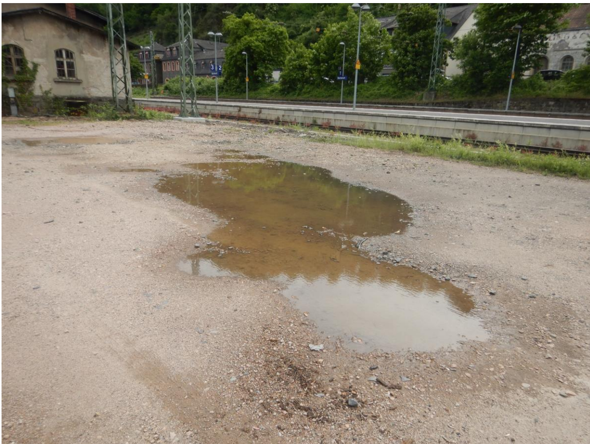
Abb. 16: Temporär Wasser führende Pützen/Senken finden sich im östlichen Bereich des Parkplatzes sowie im westlichen dem Bahnhofsgebäude vorgelagerten Bereich.
