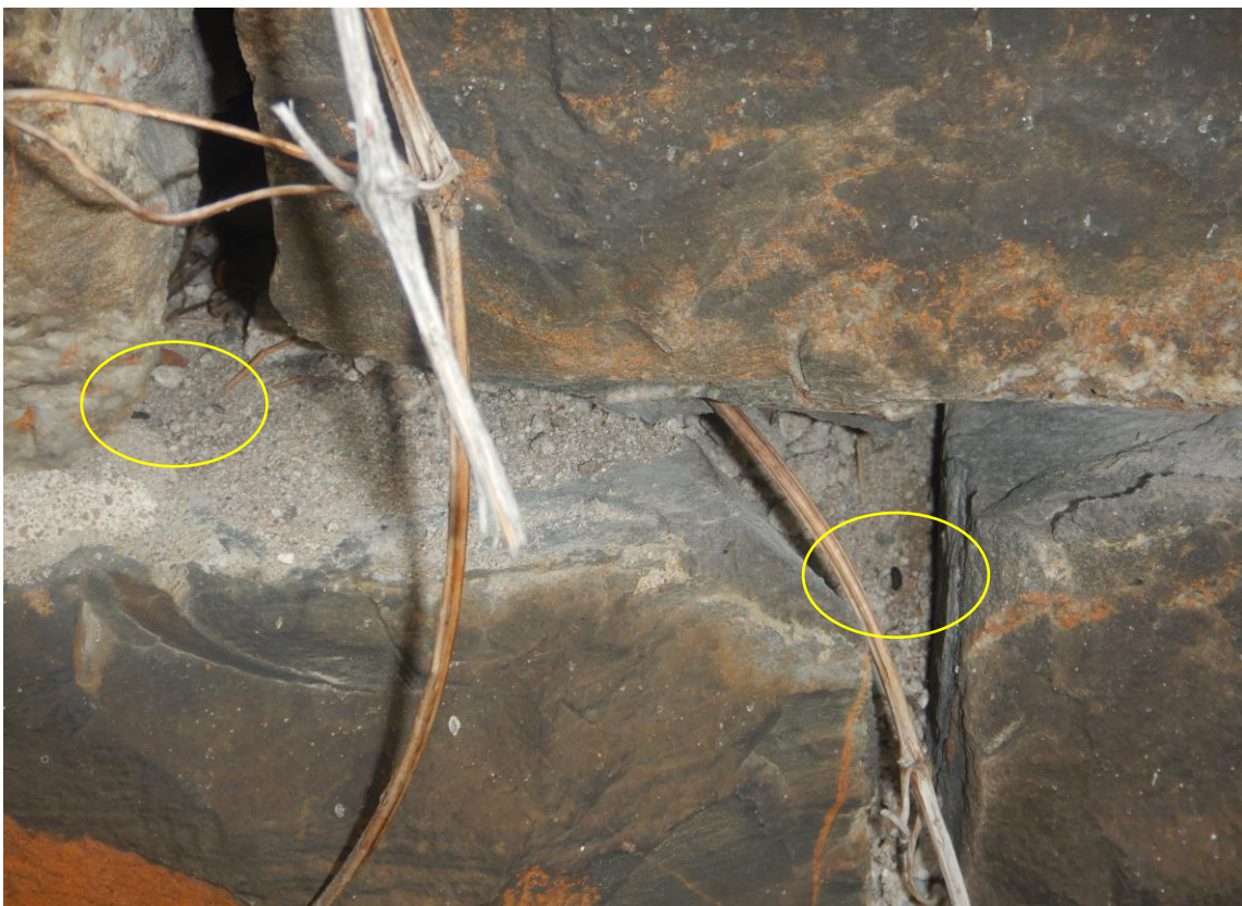
Abb. 51: Mäusekot fand sich in Mauerfugen, dieser ist mit etwas Erfahrung gut von Fledermauskot oder dem Kot der Haselmaus zu unterscheiden. Neben Mäusen siedeln im Mauerwerk des Bahnhofsgebäudes noch Mauereidechsen.
